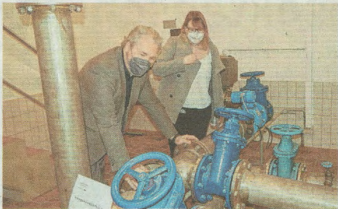
Katharina Mennicke, Leitung Technik, erklärt Thomas Wolf, Samtgemeindebürgermeister, während des Vertragstermins den Zu- und Ablauf des Frischwassers aus dem Quell- und Brunnenbereich in den Hochbehälter in der Gemarkung Blumenhagen.
